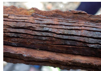
腐食した鉄筋の例
