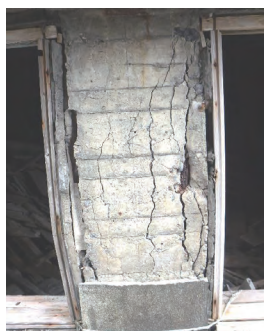
鉄筋が腐食した結果、 コンクリートに生じたひび割れの例
