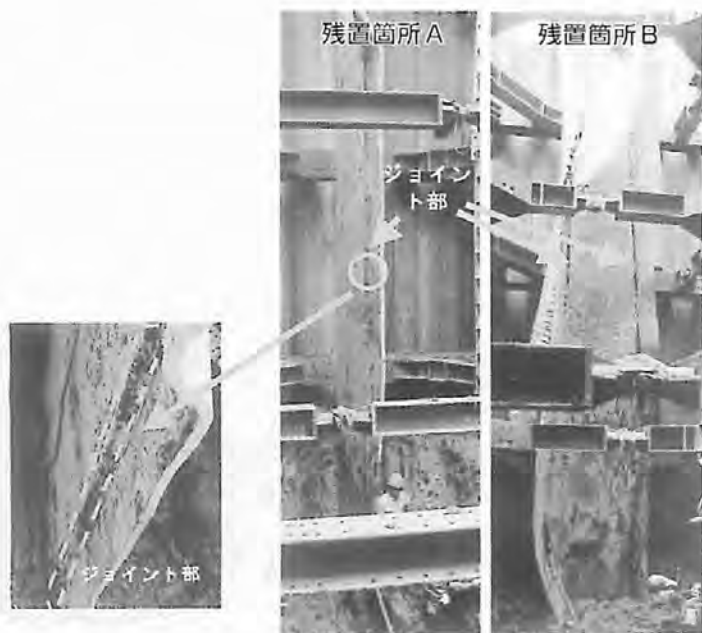
図13 残置箇所全景
