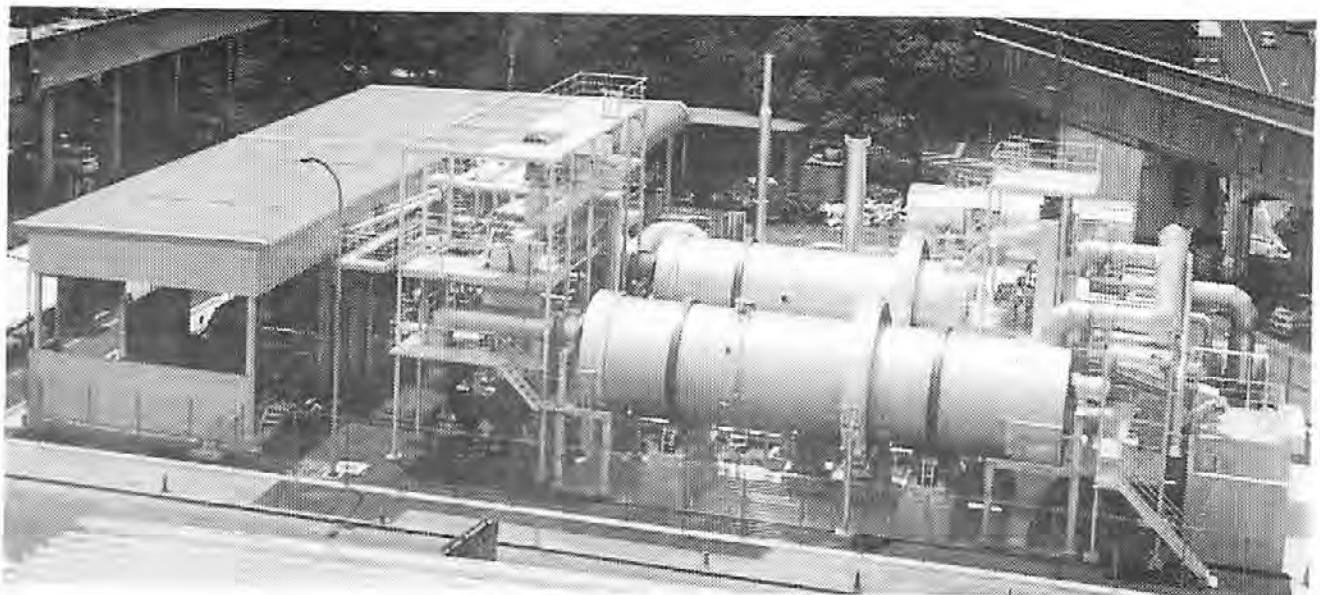
図13 実証プラント全景
